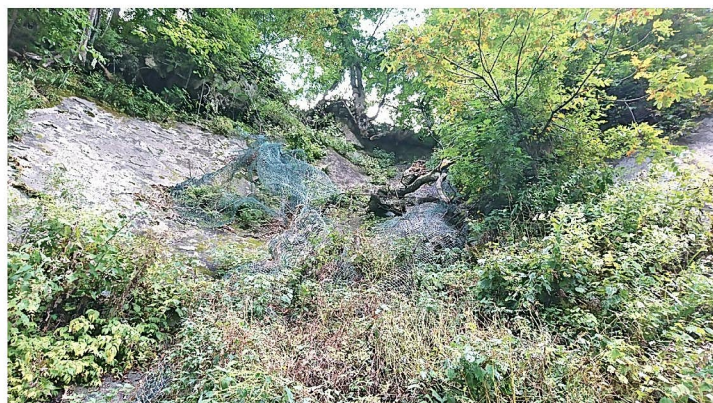
▶滑津大滝落石現場
