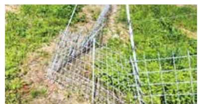
▲ワイヤーメッシュ雪害破損箇所
