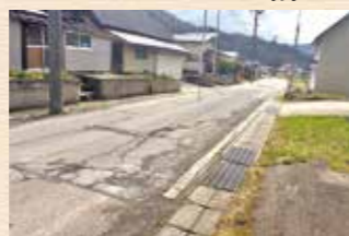
▲改修が急がれる町道
