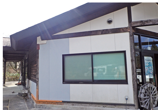
▲4月7日撮影 横川活性化施設シロアリ被害(工事中)
