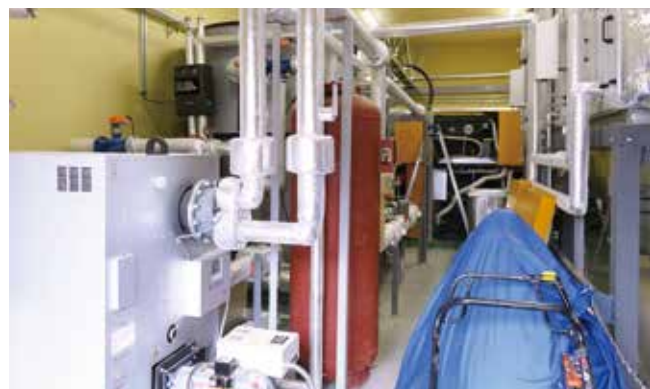
▲チップボイラー
