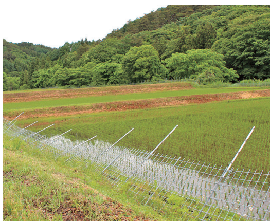
▲雪害等により倒れた鳥獣害防止柵、早い復旧が望まれる。写真は峠田地区
