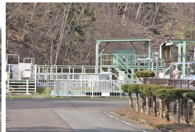
▲下水道処理場
