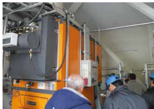
▲チップボイラー
