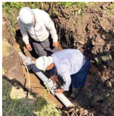
▲老朽化が進む水道管
