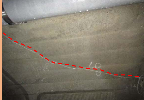
南川原トンネルの天井に発生したブロック(下図①)。はがれて落下する可能性あり。
