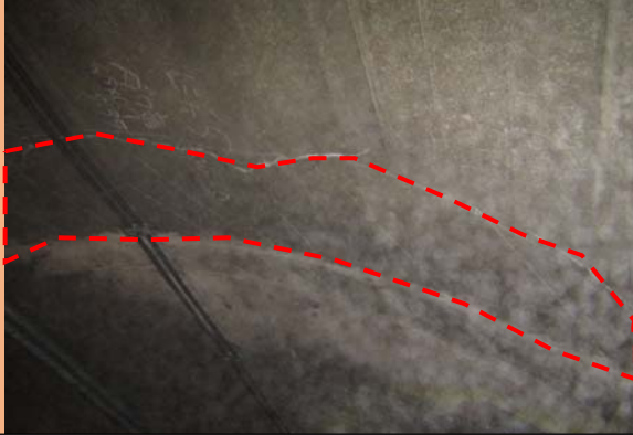
虎岩トンネルの天井に発生したブロック(下図①)。はがれて落下する可能性あり。
