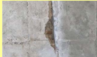
血森トンネルの目地に発生したうき(下図②)。将来、破片落下の可能性あり。
