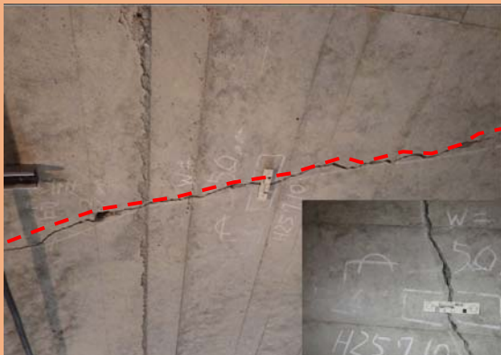
平畑トンネルのアーチ部横断方向のひび割れ(下図③)。ひび割れ測定ゲージで監視中。
