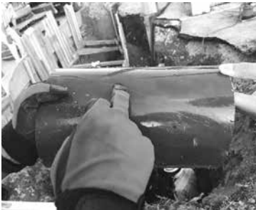
水道管の亀裂
